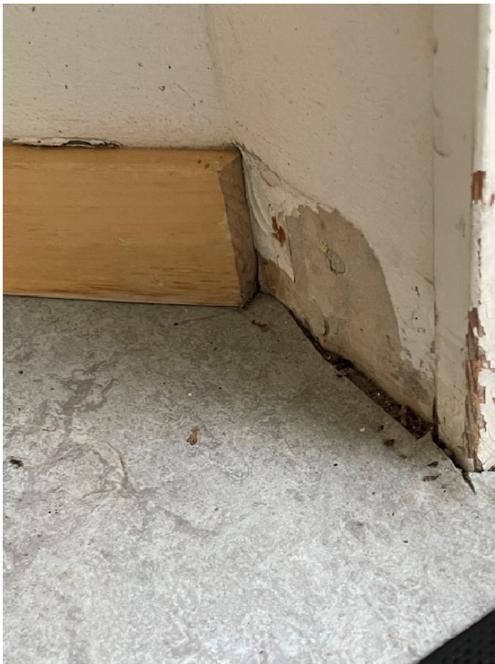
Figur 7, Hörn yttervägg vidd dörr, fukt?
