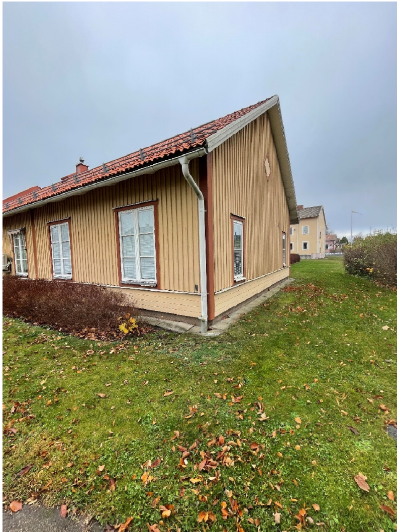
Figur 10, Fasad med fönsterbleck med färgsläpp
