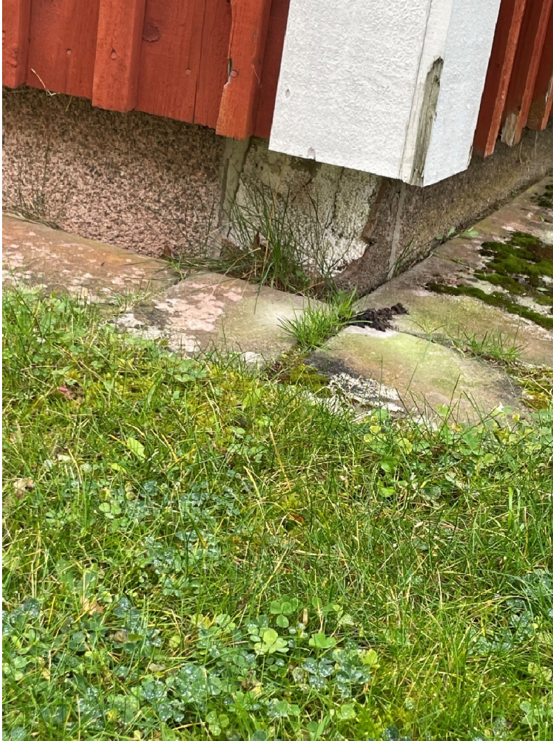
Figur 11, skadad sockel med frilagd isolering
