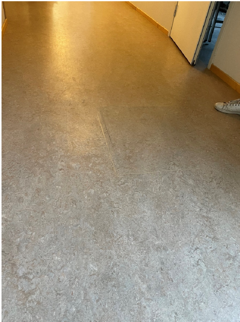
Figur 8, Golv med igensatt lucka?
