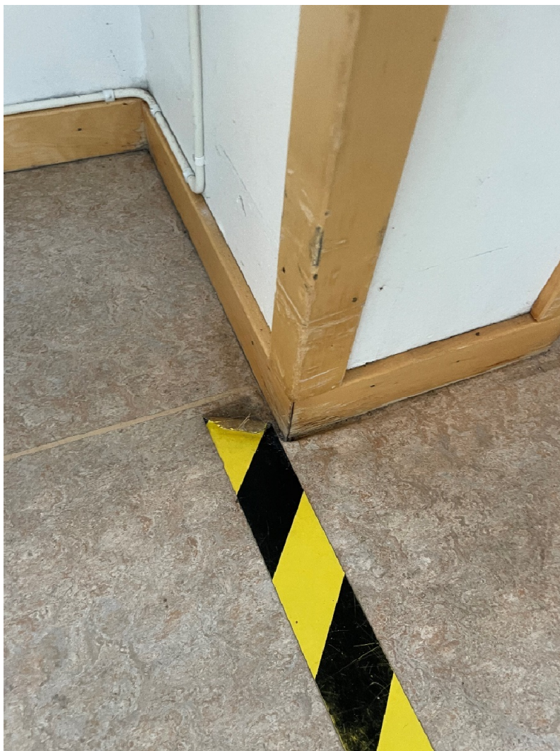
Figur 4, Hörn yttervägg, fukt?
