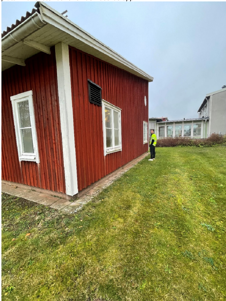
Figur 9, fasad mot nordväst, skadad panel.
