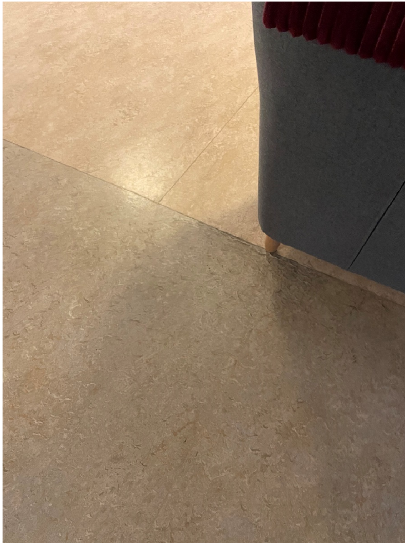
Figur 3, golv med tryckskador
