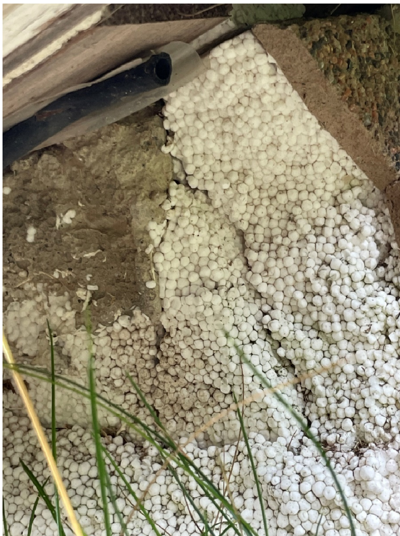
Figur 12, skadad sockel med frilagd isolering
