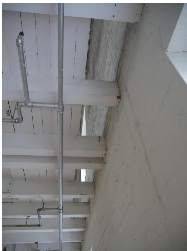
Luftning i bjälklaget.
