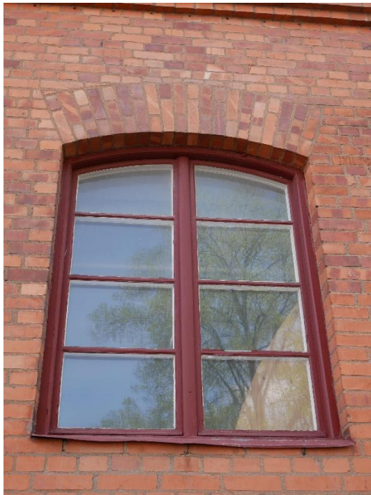
Fönsterbåge i originalutförande.
