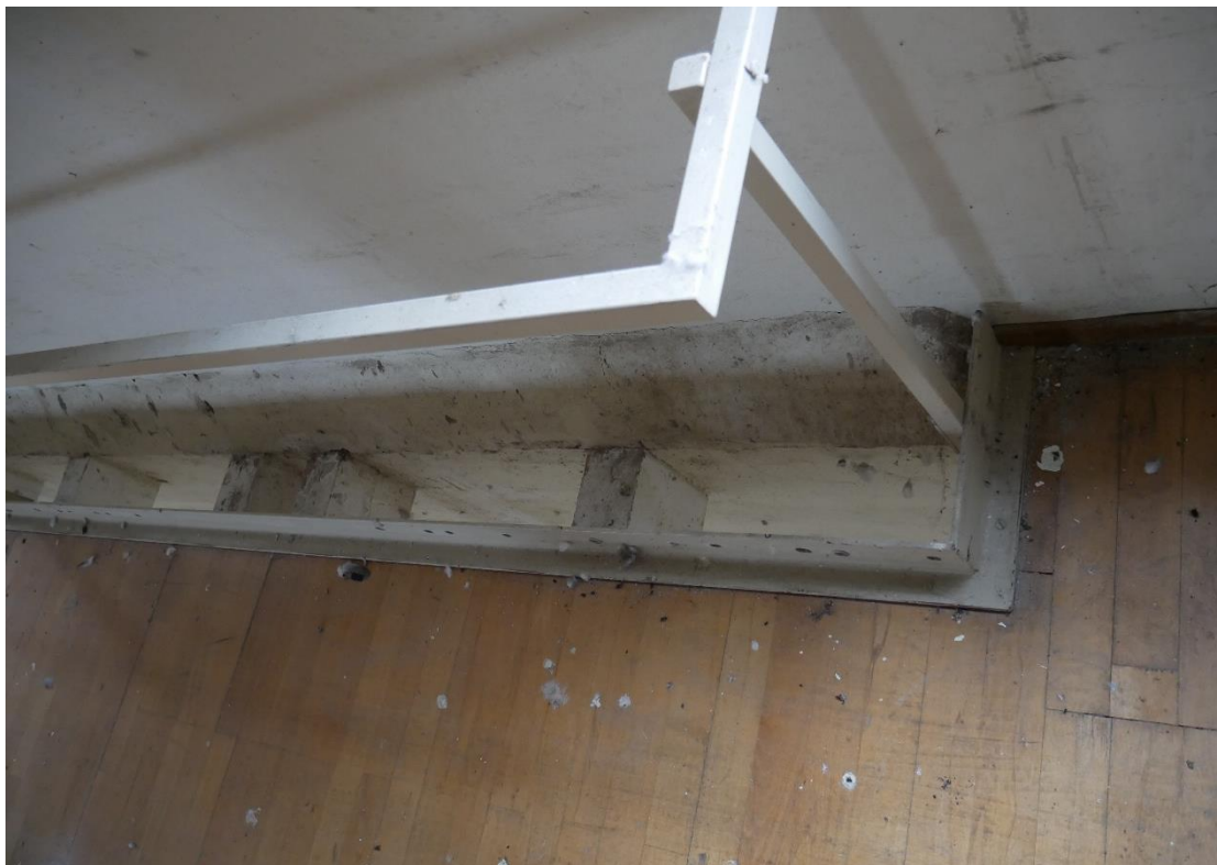
Luftning i våningsbjälklagen. Golvet har en smal stavparkett.
