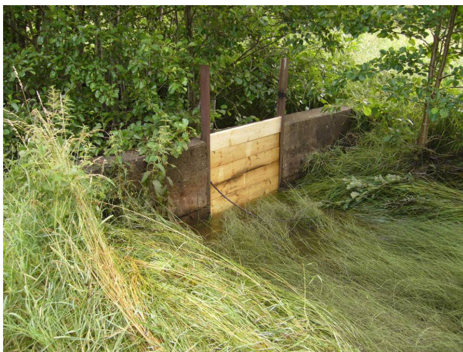
Figur 4.4.1. Dämme vid idrottsplanen, 2007-07-10. Foto: Mjölby kommun
