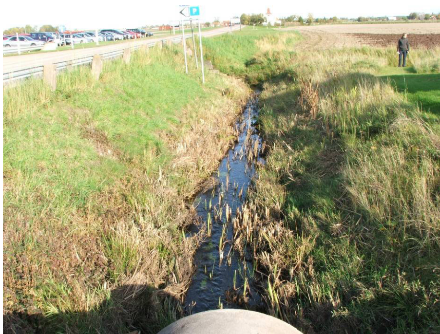
Figur 3.13.1. Vy nedströms vid infarten till Surbo avloppspumpstation, 2008-10-03.
