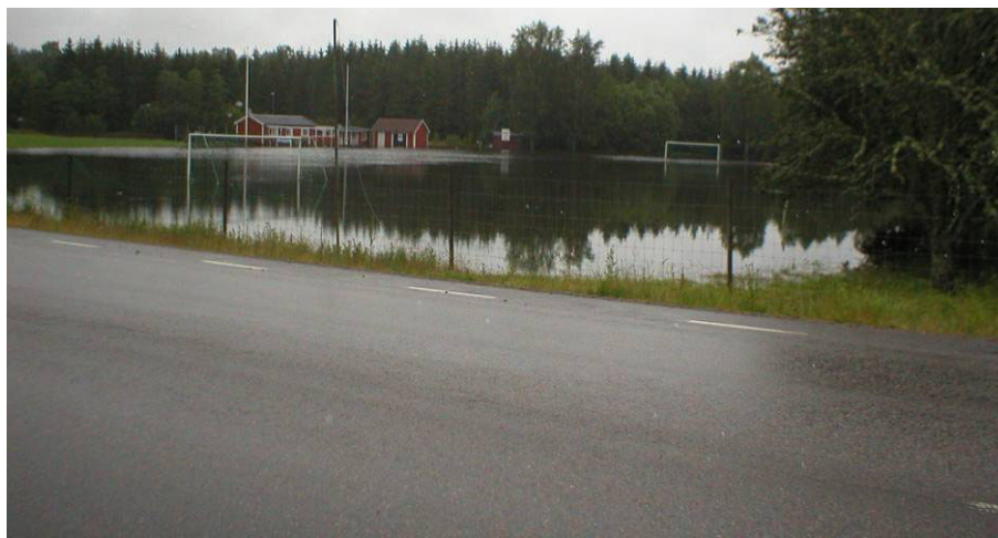
Figur 4.1.1. Väderstad IK:s (tidigare) fotbollsplan, 2007-07-10 efter avsiktlig blockering av trumma. Foto: Mjölby kommun
