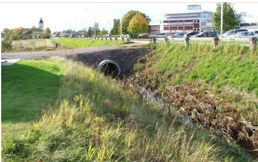
Figur 3.12.1. Vågtrumma vid Surbo avloppspumpstation, 2008-10-03. Foto: Sweco
