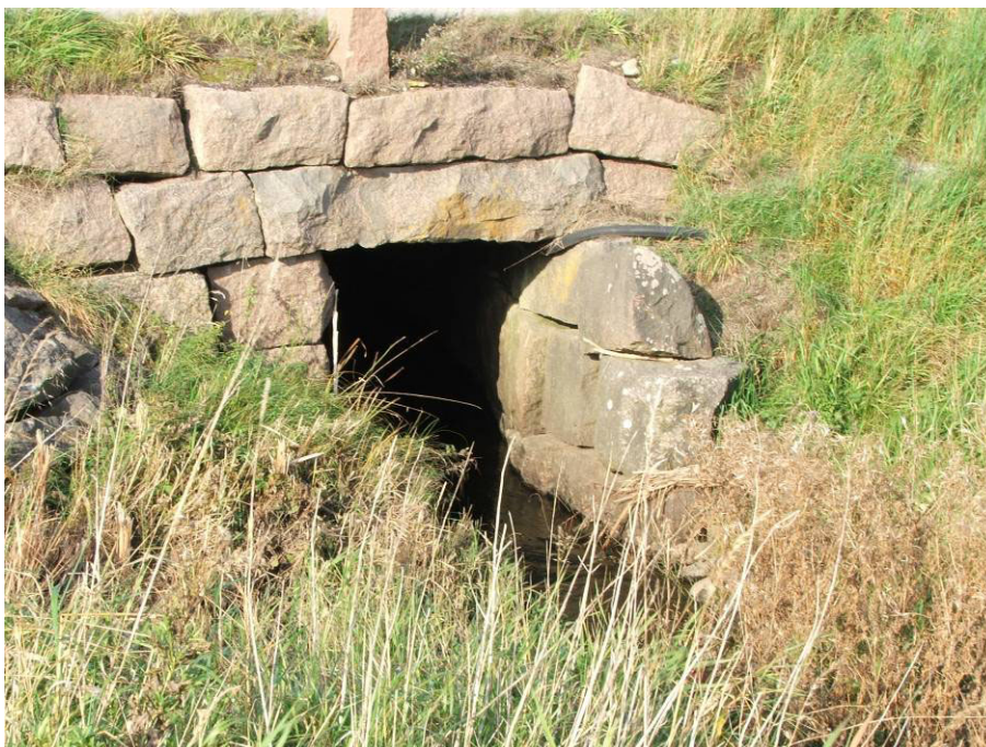
Figur 3.14.1. Inlopp till kulvert under Folkungavägen-Hogstadvägen, 2008-10-03. Foto: Sweco
