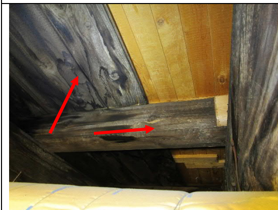
Vind Lokstall ovan kontorsdel, Trämateriell generellt behandlat med träskyddsmedel av typen kreosot med innehåll av PAH
