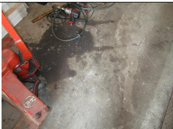
Exempelfoto över betonggolv förorenat av petroleumprodukter gäller generellt samtliga golvytor som används som verkstad eller använts i äldre verkstadsverksamhet.
