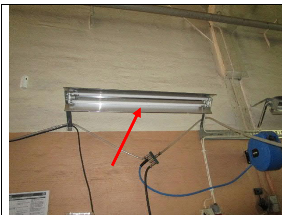
Äldre lysrörsarmatur med innehålla av kvicksilver och risk för PCB-innehåll i kondensatorer.
