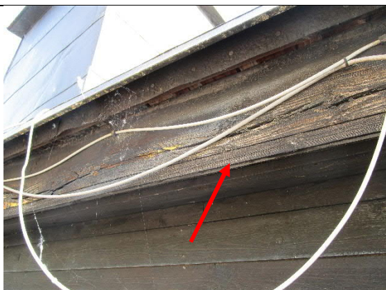
Övre takfot på lokstall, innehåller höga halter av PAH, troligtvis kreosotbehandlat virke.
