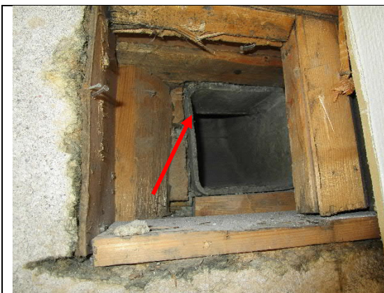
Exempel på eternitkanal med sannolikt asbestinnehåll
