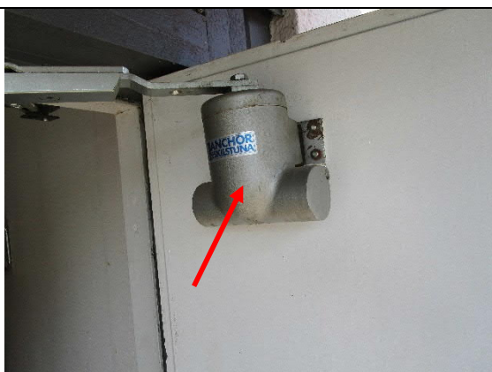
Exempel på äldre dörrstängare, kan innehålla PCB-olja.
