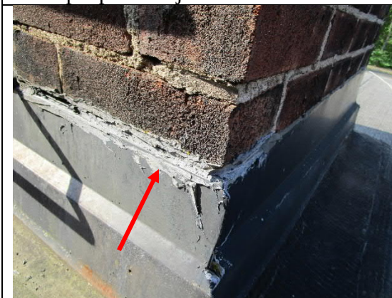
Fogmassa vid skorsten, asbest påvisad.
