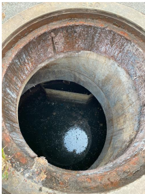
Figur 8. Foto på oljeavskiljaren. Prov uttogs med Bailer den 29 augusti 2024. Foto: Tyréns AB.
